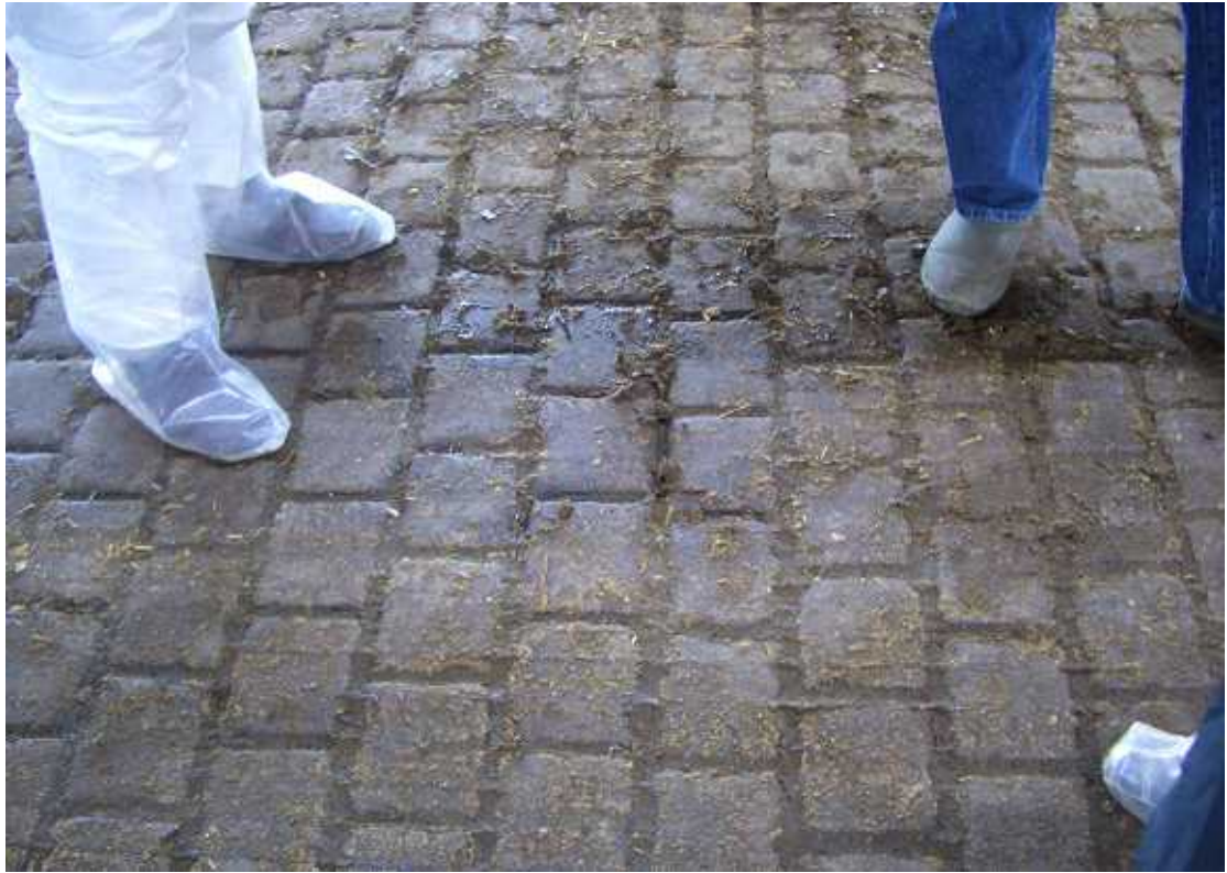
通路の床の構造 牛の蹄底を傷つけることなく、すべらず、歩きやすくする
